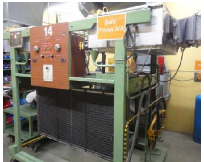
Equipo en un banco de pruebas Condensador, evaporador y compresor
